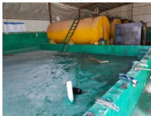
厂房内部卸油区
